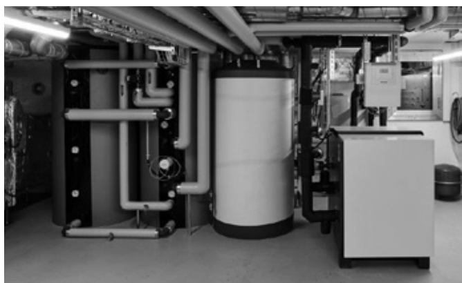
Wärmepumpe mit Speichern (©Fengari AG)
