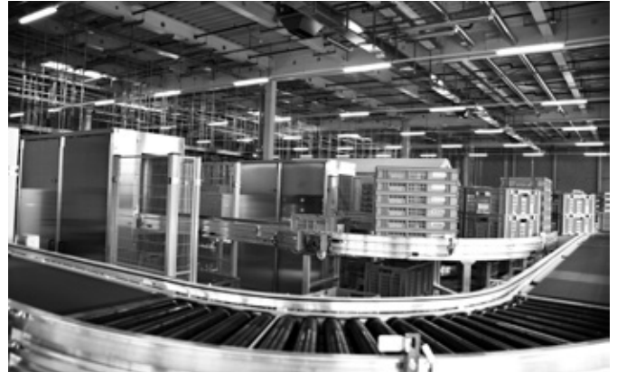
Die aktuelle Sortieranlage im Gebäude DELTA
